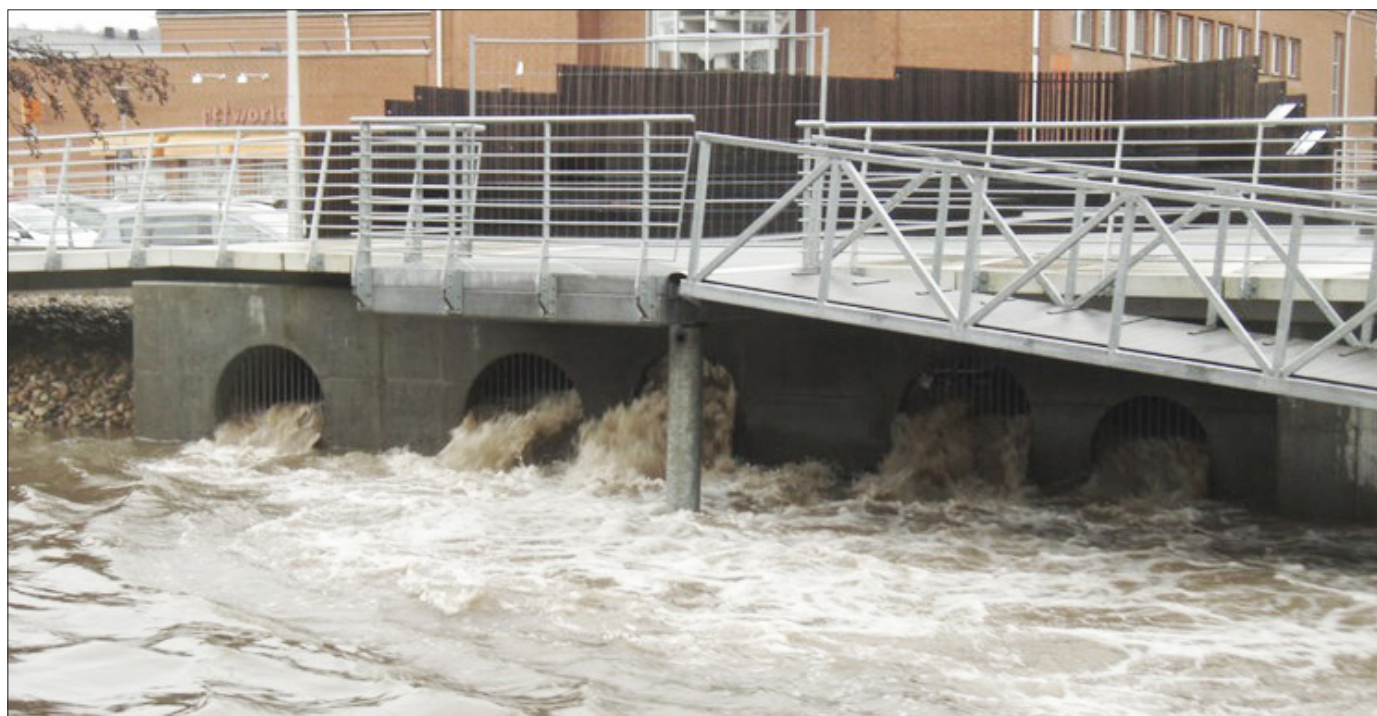
Sluse- og pumpebygværket i drift.
